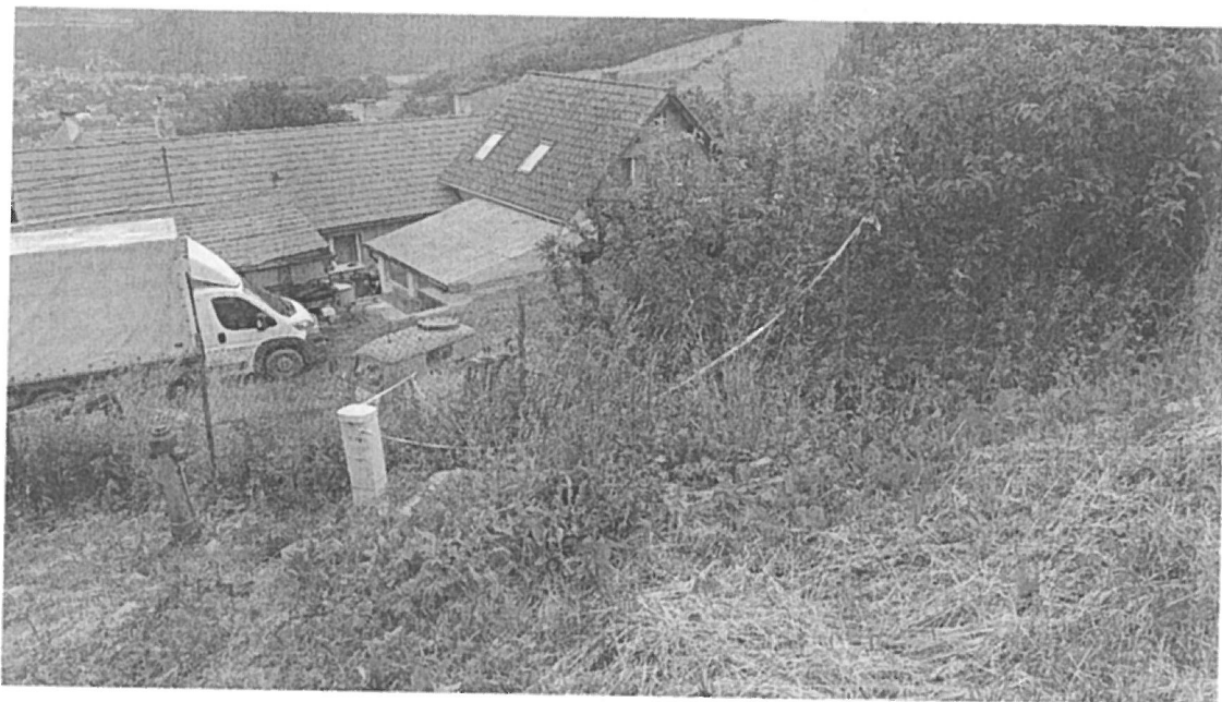
Obr.1 k bodu 5b) – nedokončená oprava u objektu Pod Lipami 26
