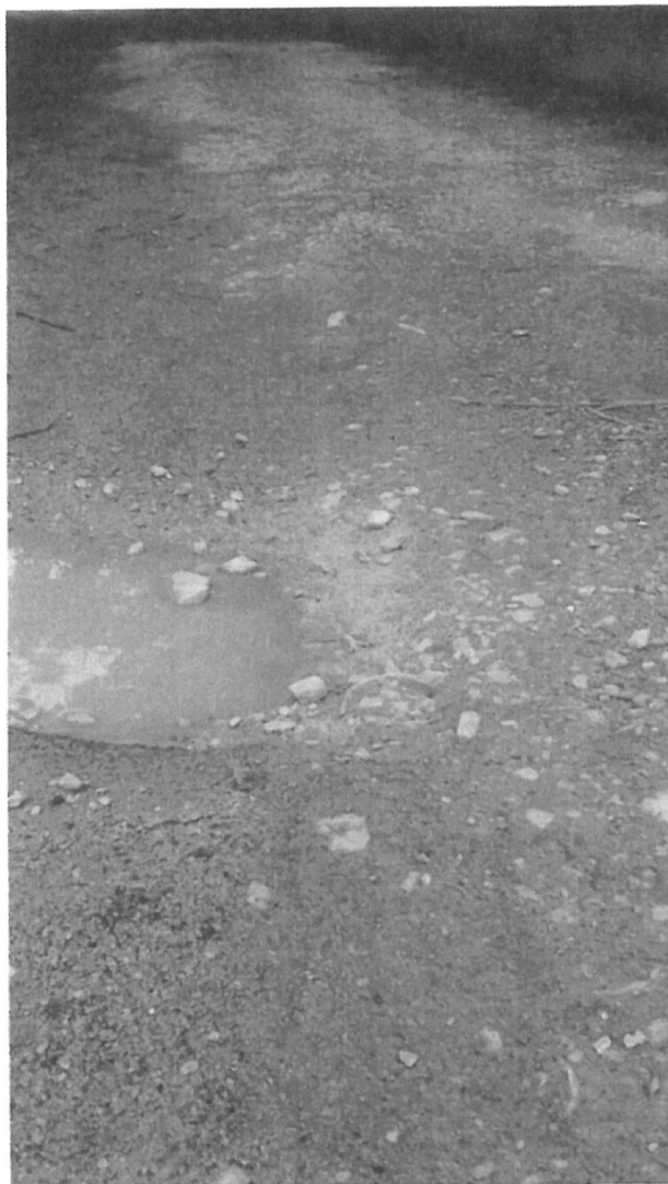
Obr. 1,2. – zbytky eternitových trubek v horní části ulice Lesní
