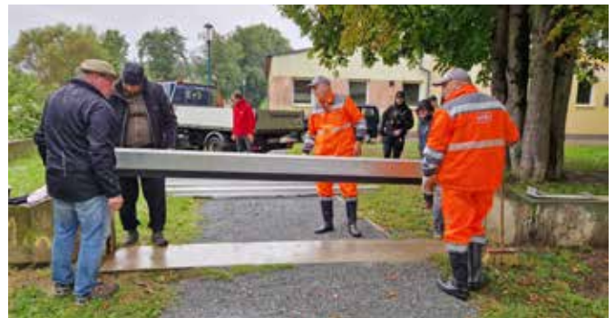
■ Z preventivních důvodů jsme postavili povodňovou bariéru u Domova penzionu pro seniory.
