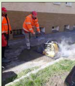
■ Po zimě bylo potřeba provést opravu i na chodnících, kde došlo k propadu povrchu.
